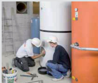
Inbetriebnahme eines Wassererwärmers Der Anschluss, die Überprüfung und die Inbetriebnahme eines Wassererwärmers gehören zu den vielfältigen Aufgaben.
