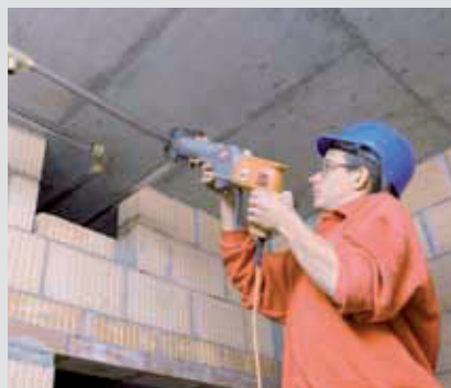
Der Einsatz von Handwerkzeugen Beim Verlegen der Rohre kommen Presswerkzeuge, Akkuschauber, Metermass, Rohrschellen und vieles mehr zum Einsatz.
