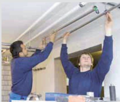
Montage der Kellerverteilung Im Keller wird das Trinkwasser über eine Verteilbatterie an den Elektrowassererwärmer und zu den verschiedenen Verbrauchern geführt. Montagepläne helfen dabei.
